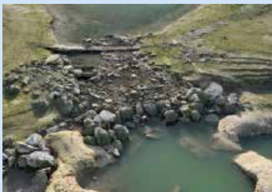
Modèle 3D de la fosse de dissipation du déversoir d'extrémité du canal d'amenée Seine (vidange 2025)
