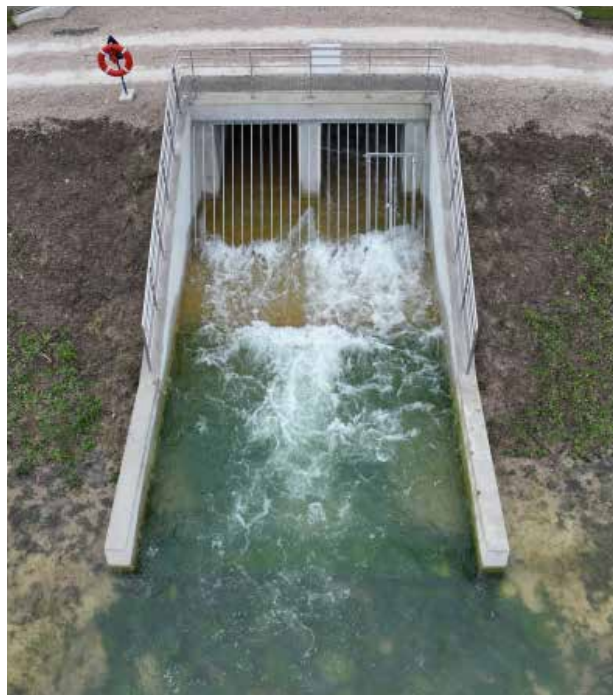
Pompe de l'ouvrage annexe de Roselle
