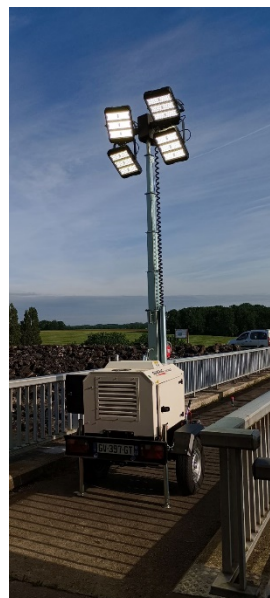
Mât d'éclairage déployé au cours de l'exercice
